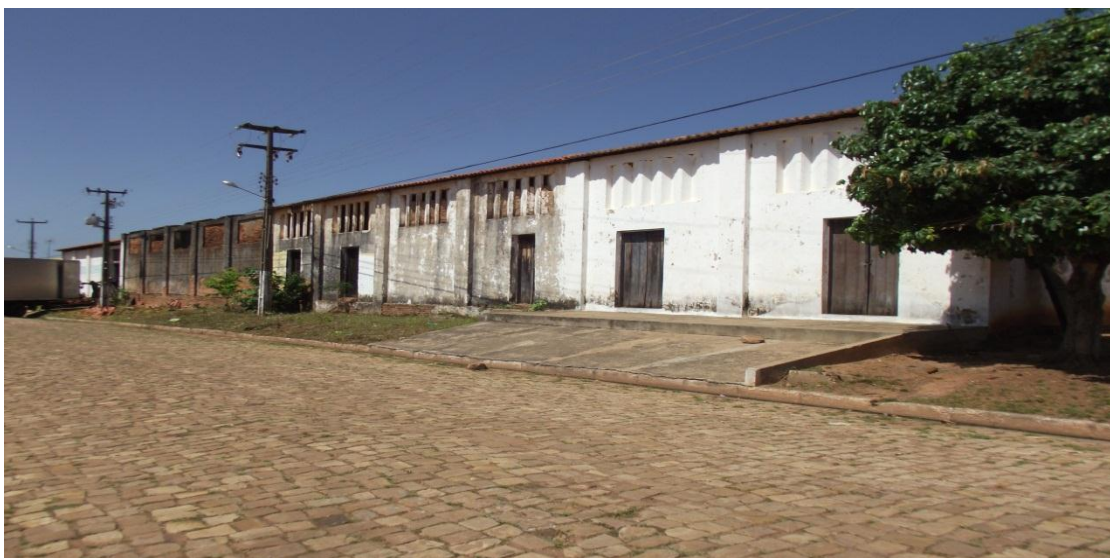
Figura 08: fotografia de outro Galpão construído pelos imigrantes alemães em Santa Rosa do Piauí, década de 1963, localizado na Rua da cooperativa, Bairro Fazenda, em Santa Rosa Piauí (PI).
