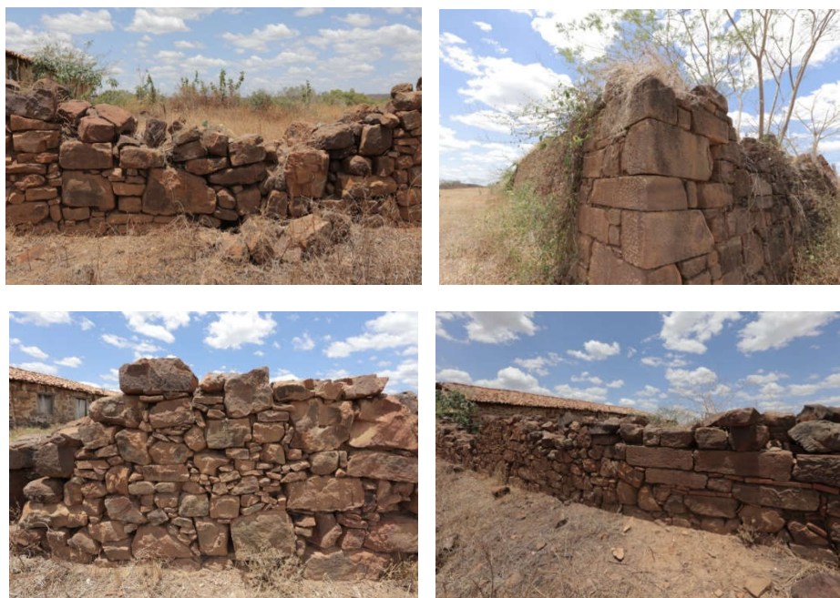
Figuras 2, 3, 4, 5 – Muros de pedras em ruínas da Fazenda do Serra Negra
